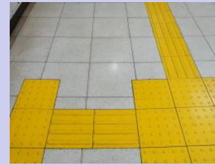
視覚障害者誘導用ブロック
